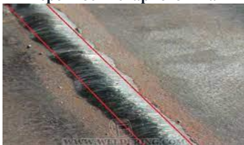
неравномерность/ неровность сварного шва
