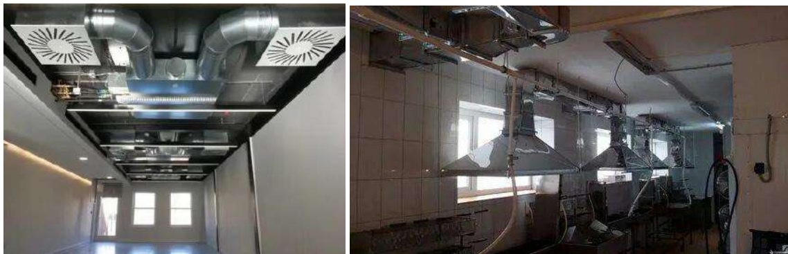
Фото 19 - Приточная и вытяжная вентиляционные установки
